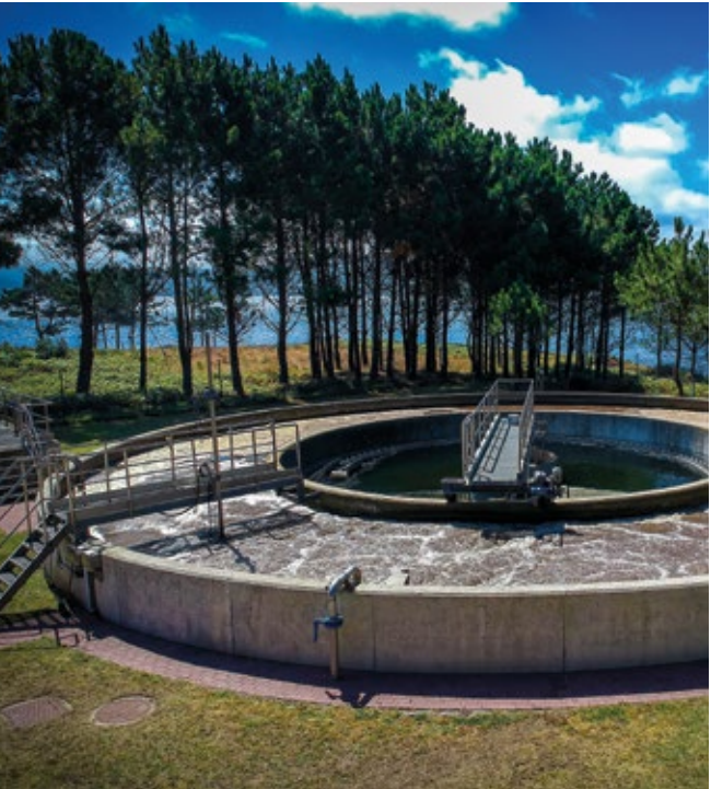
▼ EDAR de Camariñas (A Coruña)
